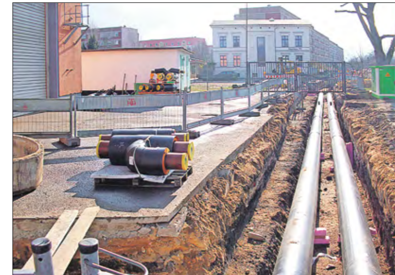
Die Straßenerneuerung in der Geschwister-Scholl-Straße wurde genutzt, um eine rund 40 Jahre alte Fernwärmetrasse auszutauschen.
