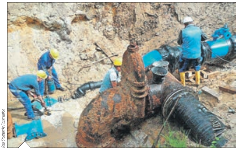
Der Austausch der Schieberbaugruppe am Finsterwalder Wasserwerk geschah 2014 und erforderte Präzisionsarbeit vom Bauteam.
