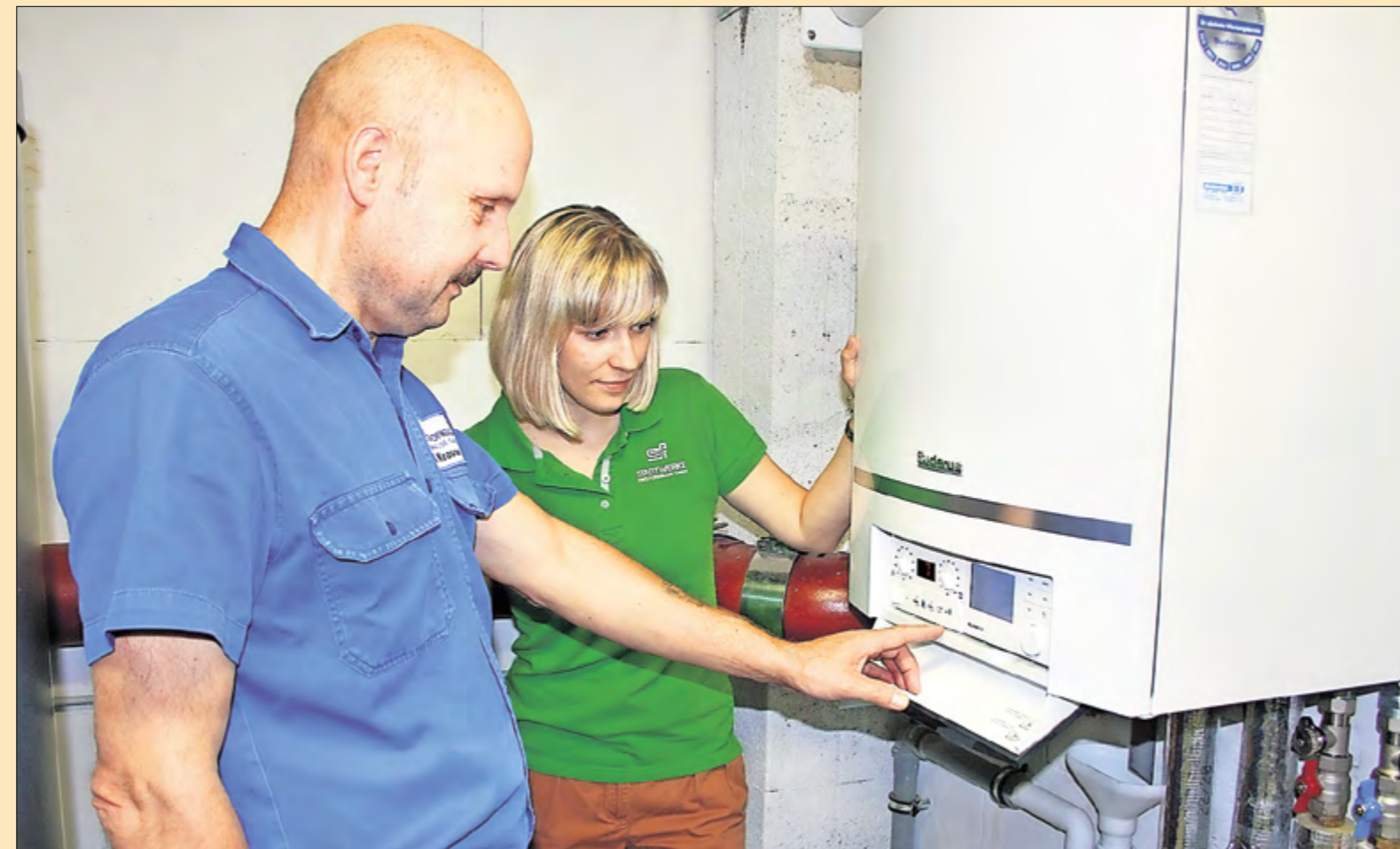
Sabrina Zierenberg (Teamleiterin Verkaufsservice) und Uwe Krause (Meister Wärmenetz) besichtigen eine moderne Heizungsanlage – eine Gastherme (33 kW) auf dem technisch neuesten Standard – für ein Mehrfamilienhaus.
