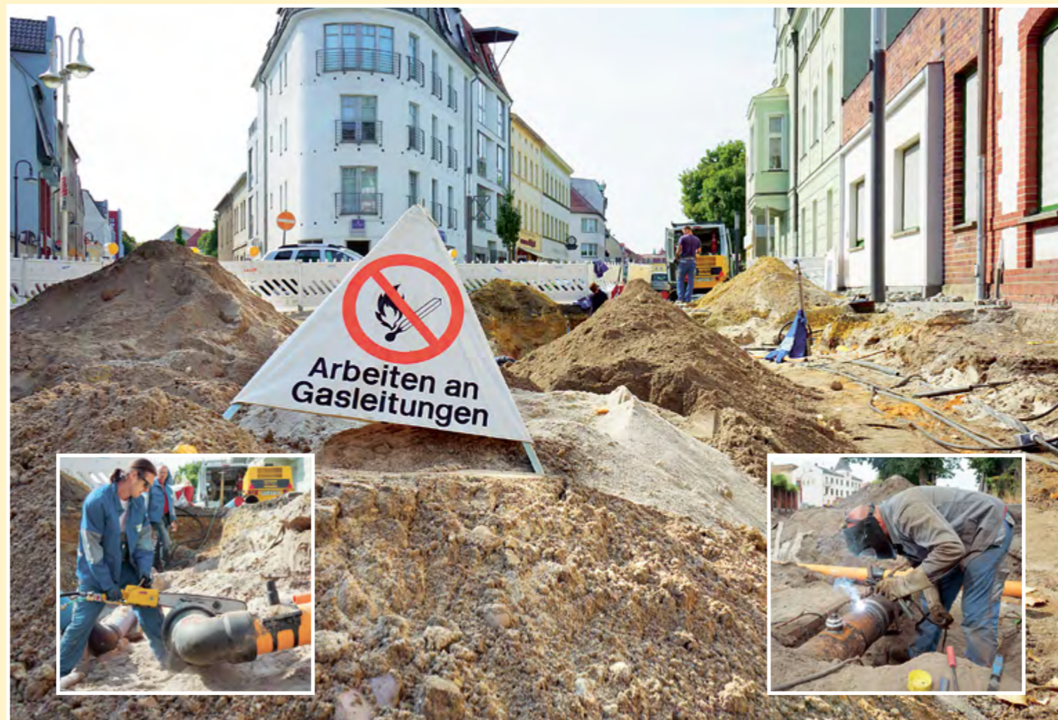
Dieses Jahr wurde mit Hochtouren an der Erneuerung der Finsterwalder Verkehrsader gebaut - hier der Blick in die Berliner Straße Richtung Marktplatz (großes Foto). Die Rohre für die Gasleitungen mussten zuerst durchtrennt (kleines Foto links) und im Anschluss zusammengefügt werden (kleines Foto rechts). Fotos (4): SF
