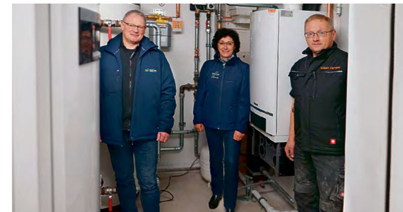
Die Wärmecontracting-Anlage der SF im Keller des WoGe-Mehrfamilienhauses in der Schillerstraße: Thomas Freudenberg, SF-Bereichsleiter Rohrnetze, Gabriele Brungart, Technischer Vorstand der WoGe und Thomas Hustan von der Killian Heizungs- und Sanitärtechnik GmbH (v. l.) überzeugen sich von der Funktionstüchtigkeit.
