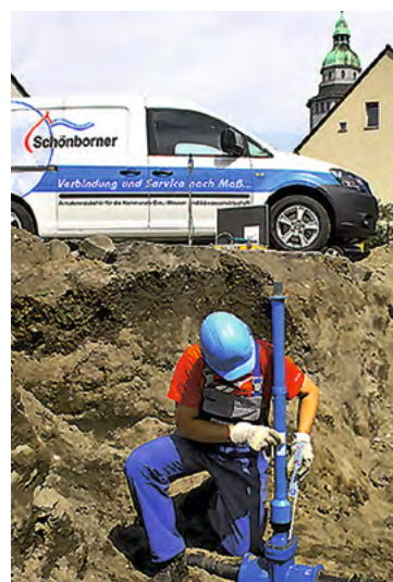
Verbindungen nach Maß: auf einer Baustelle in der August-Bebel-Straße in Finsterwalde montiert ein Mitarbeiter des Unternehmens die Schönborner Armaturen.
