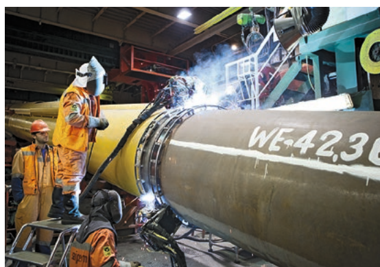
Im Mai 2011 wurde der letzte Abschnitt der Nord Stream-Pipeline gebaut. Seitdem fließt russisches Erdgas direkt nach Deutschland.
