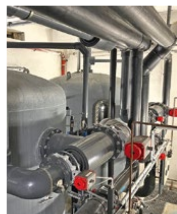
Die Filter: In den Tanks wird das Wasser wieder gereinigt.
