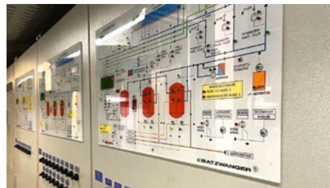
Der Schalt- und Steuerungsschrank: Auf einen (Experten-)Blick ist hier zu sehen, ob alles ordnungsgemäß funktioniert.
