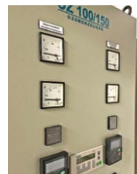
Der Ozonerzeuger: Ozon ist bei der Desinfektion des Wassers eine wichtige Komponente.
