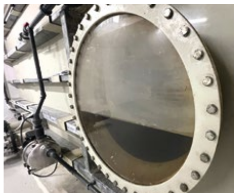
Die Schwallwasserkammer: Hier sammelt sich das Wasser, das über den Beckenrand läuft.
