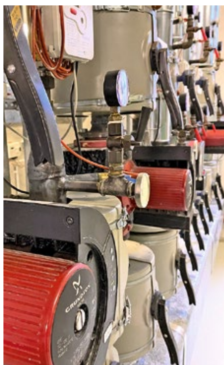
Die Wärmeverteilung: Diese Anlage ist für ein optimales Raumklima in der Halle unverzichtbar und dafür zuständig, dass die Temperaturen für die Besucher angenehm sind.
