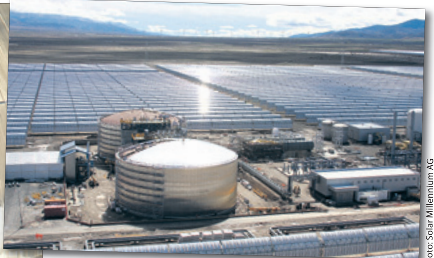
Der thermische Speicher (vorn im Bild) fasst 28.500 Tonnen Flüssigsalz.
