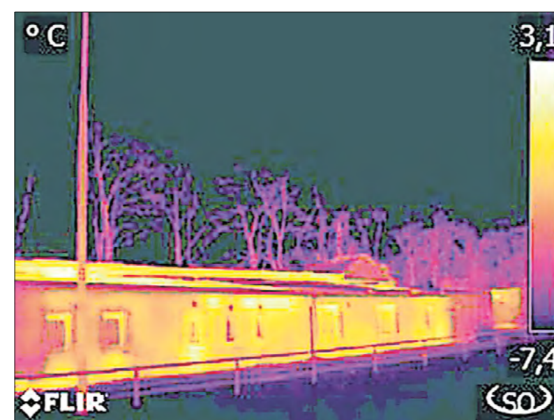
Das so genannte „Wärmebild“ vom Vereinsgebäude zeigt, dass vor allem am Dach und an den vorderen Fenstern Wärme verloren geht.
