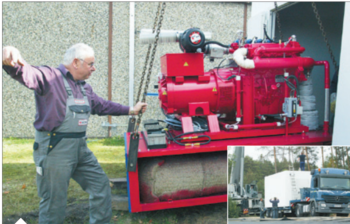
Klein und kompakt, umweltfreundlich und effizient: Das neue BHKW der Stadtwerke Finsterwalde wird montiert.
