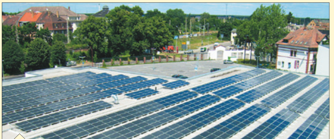
Die jüngste Solaranlage der Stadtwerke Finsterwalde GmbH an der Berliner Straße.
